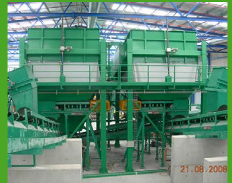
Gesamtanlage aus einer Hand
